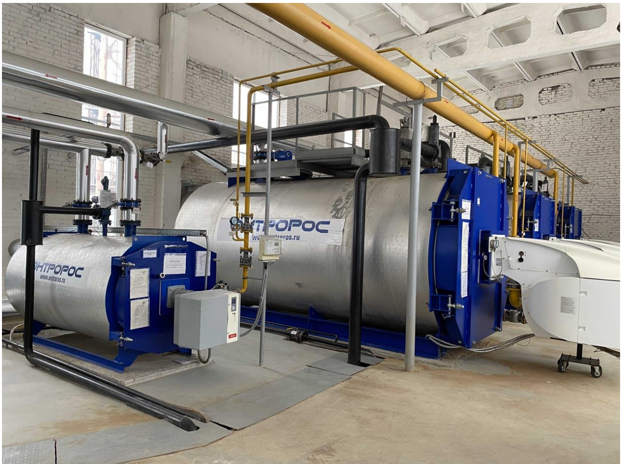
Рисунок 5.1 – Общий вид технологического оборудования котельной №1 пгт. Северный
